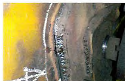
Фото 5. Многочисленные трещины в нижних поясах концевых балок с выходом на стенки
